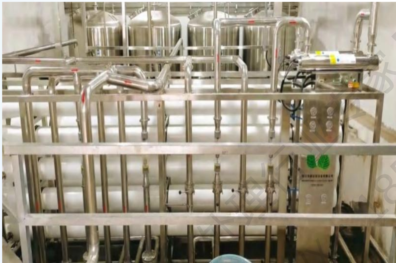
昆明国际花卉拍卖交易中心 40吨单级反渗透设备
